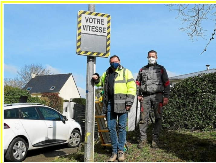
Mise en place du Radar Pédagogique Plounévezel
